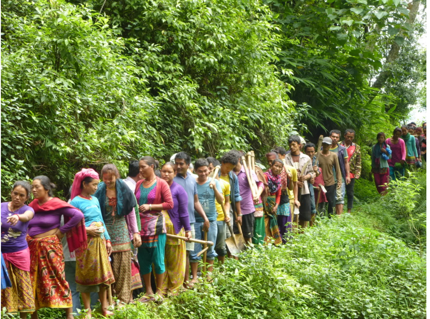
Volontari in fila per aiutare nel lavoro necessario a costruire il nuovo acquedotto di Tasarpu.
